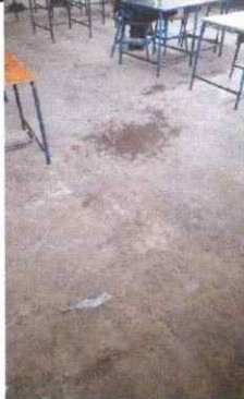
Foto 3: Se observa el piso del aula No.7 del modulo No.3 en el primer nivel en malestado, se requiere sustitución
