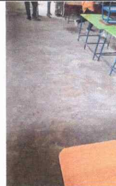
Foto 4: como se ve el piso esta en mal estado en toda el aula numero 7 del modulo 3, requiere sustitución
