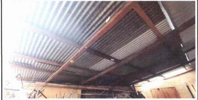
Foto 2: Se observa toda la estructura de soporte en mal estado (madera apolillada, rajada) en modulo 4
