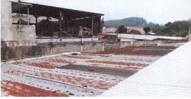
Foto 1: Se observa el deterioro de las láminas (todas oxidadas y con agujeros) en modulo 4
